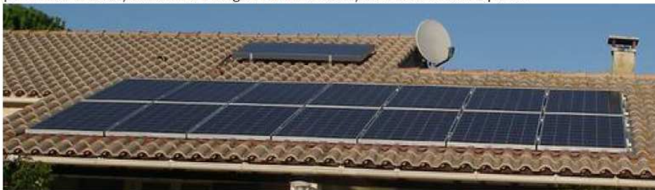
Un module solaire thermique « surimposé » avec une installation photovoltaïque « intégrée »
